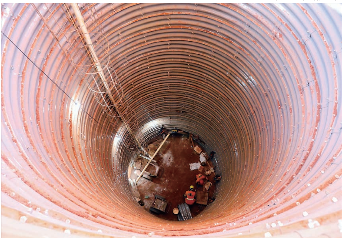
A rede de tubulação começa na altura da Arena BRB (Estádio Nacional Mané Garrincha) e vai até o Lago Paranoá
