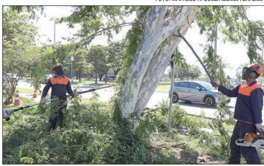
Cortes são feitos especificamente para evitar os riscos da conexão indevida de galhos com a rede elétrica
