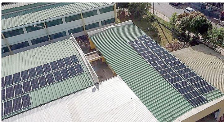
Placas fotovoltaicas no teto do CEF 801 do Recanto das Emas
