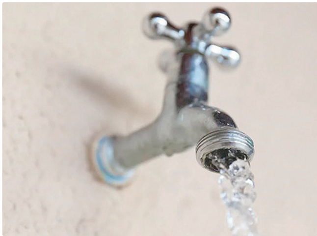
Ação é para melhorar o sistema de abastecimento nas RAs
